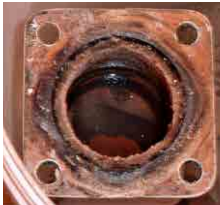
Pumphus före behandlingen.
